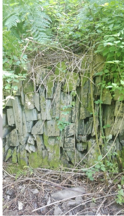
Figura 12 - particolare di muretto a secco di contenimento del versante realizzato in blocchetti di ardesia
